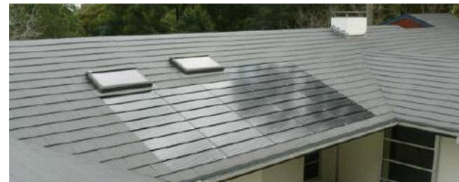
Figur 6: Eksempel på solpaneler på taget uden synlige konstruktioner
